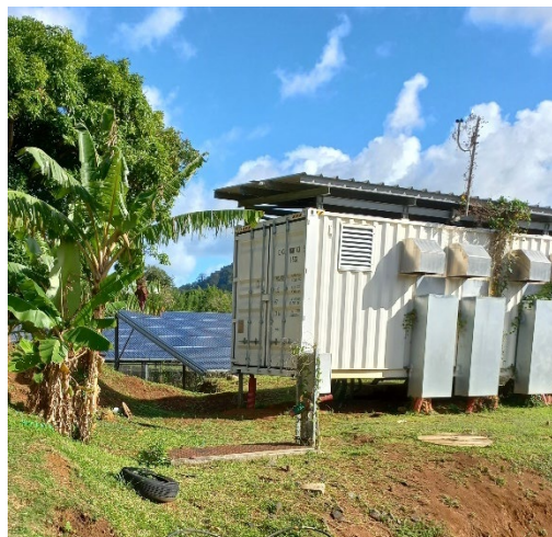
Figure 7 : Local de conversion - transformateur
