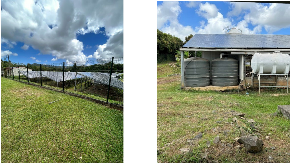
Figure 6 : Panneaux photovoltaïques au sol et en toiture
