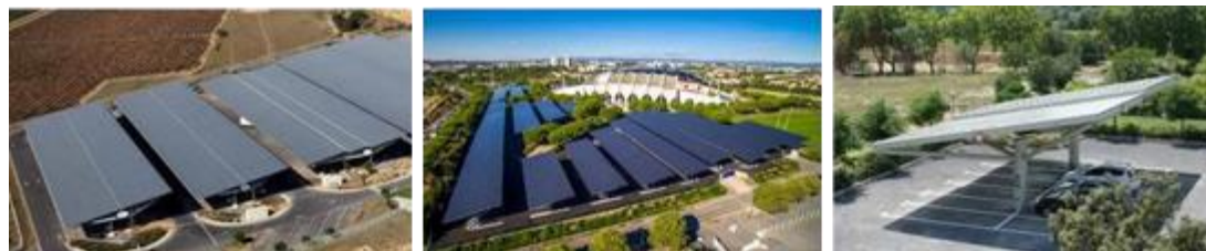
Figure 10 : Ombrières photovoltaïques (source : TotalEnergies Renouvelables France, 2023)
