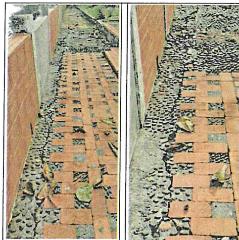
Figure 7 : Fissures en crête de mur (photographies issues du DCE pour l'étude géotechnique)
