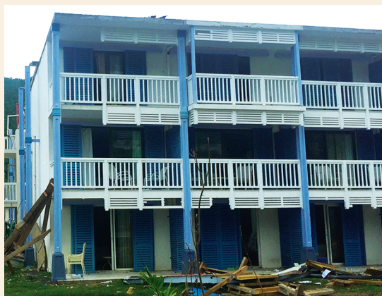
Figure 2 : Volets ventilés ayant assuré une bonne protection
