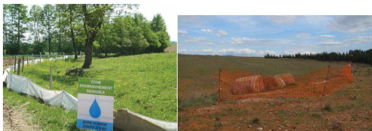
Photographie 3 : Signalétique et balisage (mise en défens) de milieux naturels à enjeux Source : EDF Renouvelables
