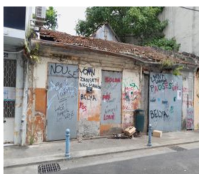
Construction en ruine rue Moreau de Jonnes
