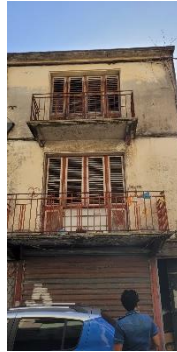
Maison instable à un stade avancé de détérioration – Rue Arago
