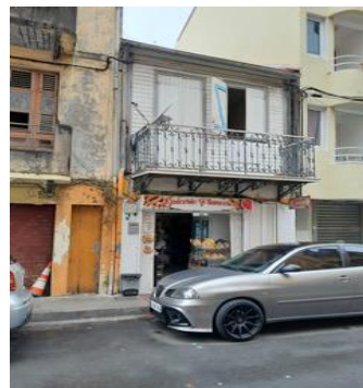
État médiocre abrite un local commercial en rez-de-chaussée et du logement en R+1 - Rue Moreau de Jonnes
