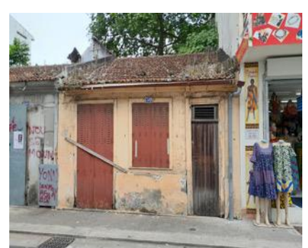
Bâti à l'abandon – Rue Moreau de Jonnes
