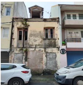
Rue Moreau de Jonnes - Edifice muré en rez-de-chaussée, proche de la ruine
