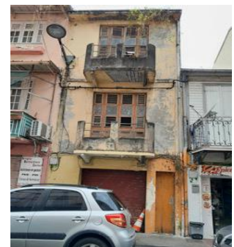
L’édifice se trouve dans un état de délabrement avancé - Rue Moreau de Jonnes
