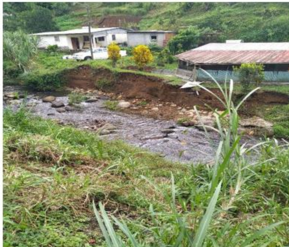
Figure 1 : Effondrement de la berge en rive gauche menaçant de ruine l'habitation du riverain.
