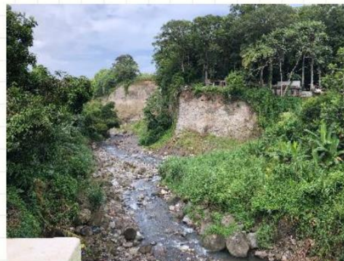
Erosion de berges au Quartier Trois Ponts à Saint Pierre
