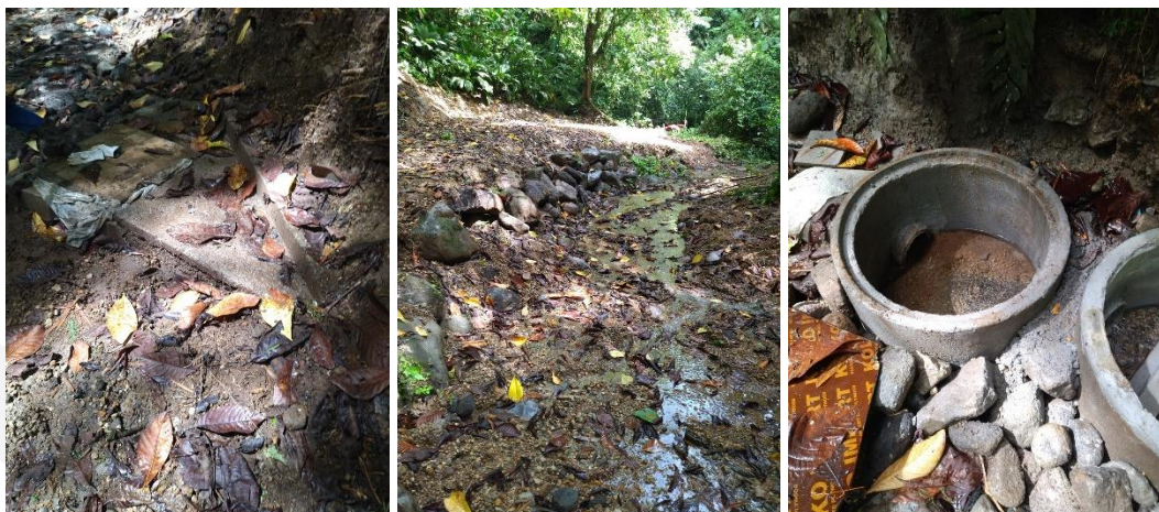
Figure 3 : Dalle béton protégeant la canalisation (gauche), enrochement au niveau de la source (centre), regards (droite) (Source : SAS HCDM)
