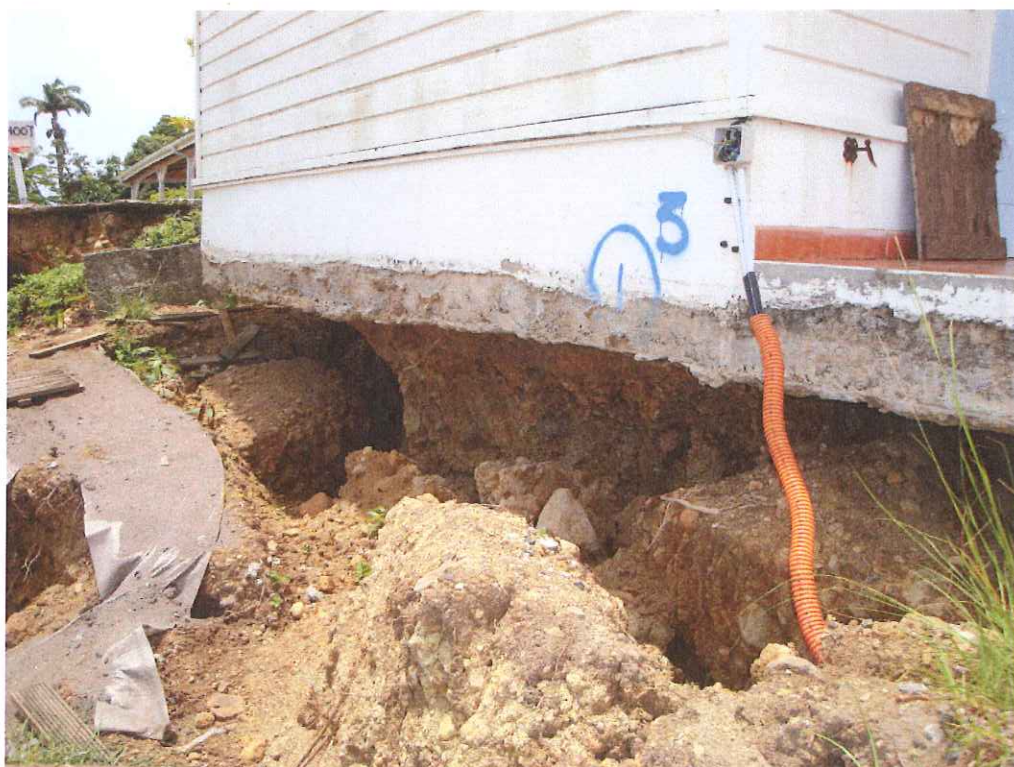
Extrémité de la villa du côté de l'allée des Manguiers avec disparition du terrain d'assise sous les longrines (fondation).
