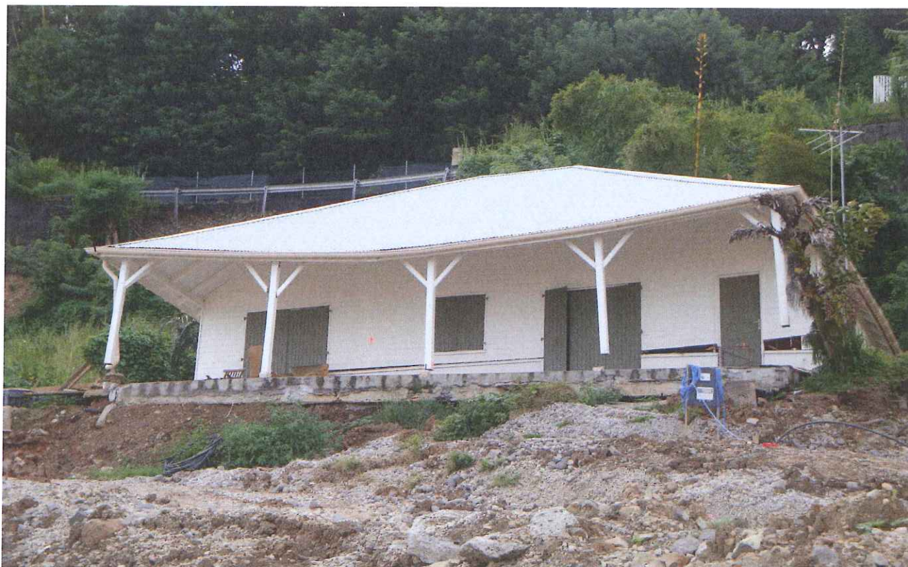
Vue de la façade avant avec la déformation de la couverture à proximité du dernier poteau de la terrasse encore relié au dallage (l'avant-dernier sur la gauche)
