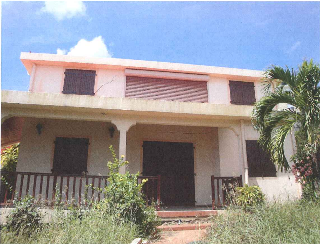
Vue de la façade côté allée des Manguiers. A noter le décalage entre l'escalier d'accès et la terrasse ainsi que la fissure à l'étage, sur la gauche
