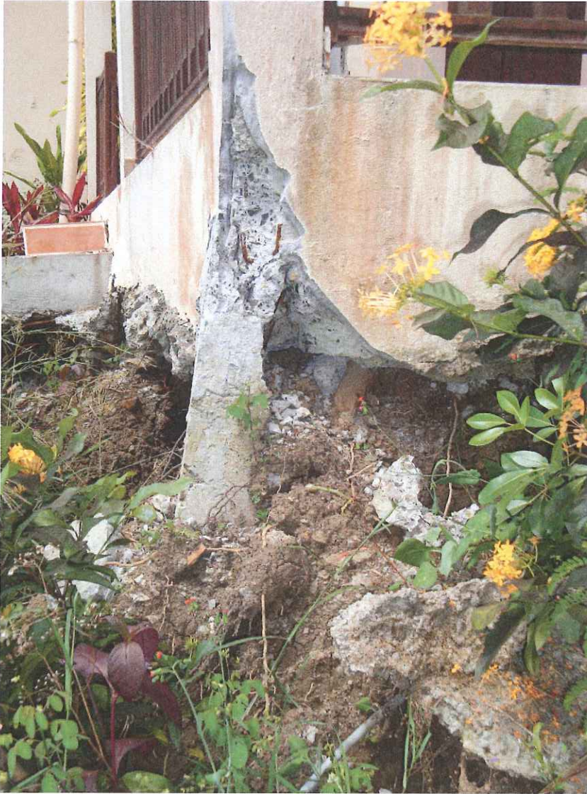
Etat de la fondation dans l'angle des façades « impasse du Verger – allée des Manguiers »
