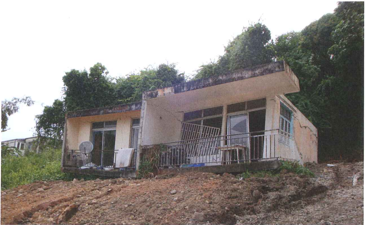
Vue de face de la maison avec un affaissement assez marqué vers le milieu de la façade
