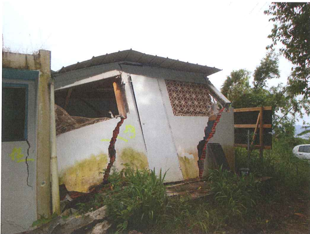
Etat très dégradé de la construction complémentaire à l'arrière avec murs en briques et couverture en tôle.
