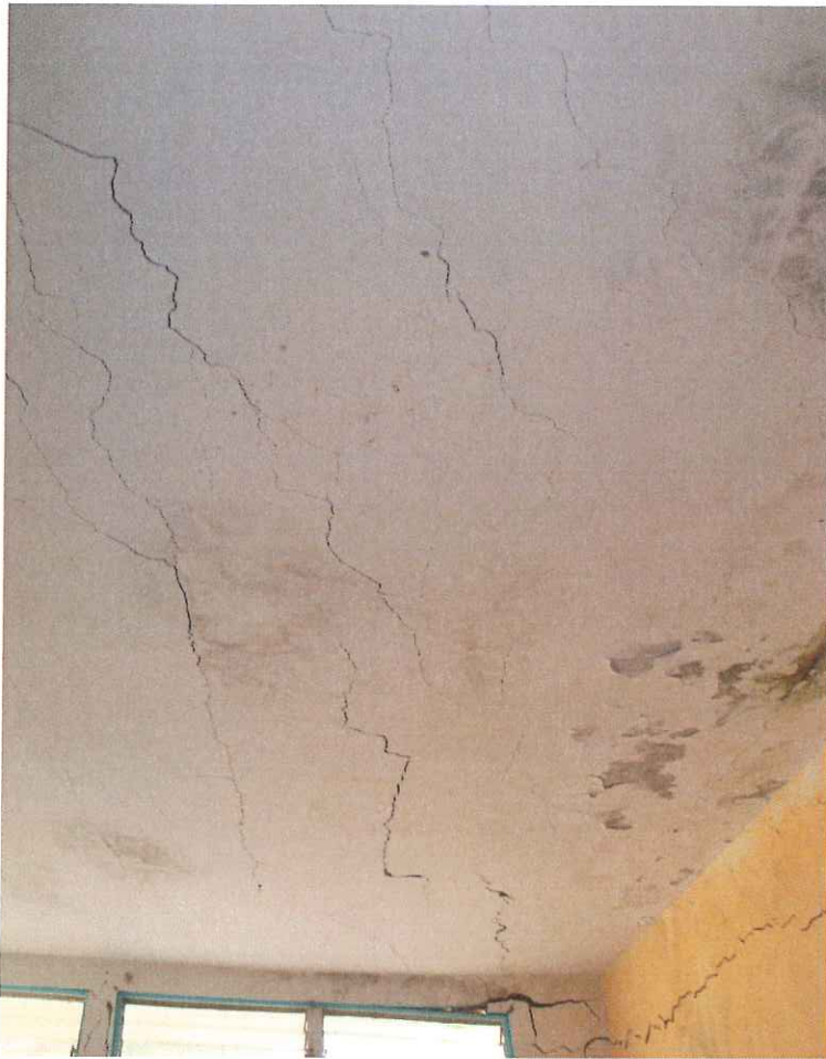
Fissures dans la dalle de couverture
