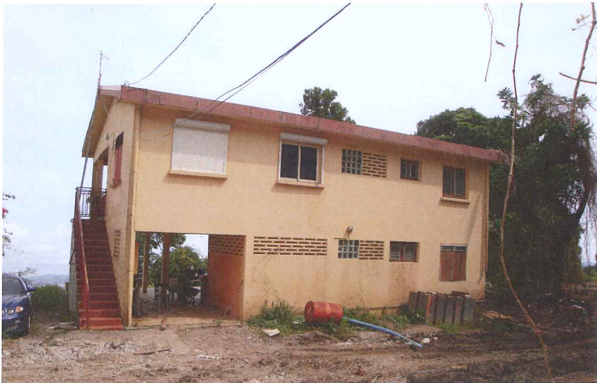
Vues d'ensemble de la villa avec au rez-de-chaussée une surface « ouverte » relativement importante. A gauche sur la vue arrière, l'escalier extérieur d'accès à l'étage.
