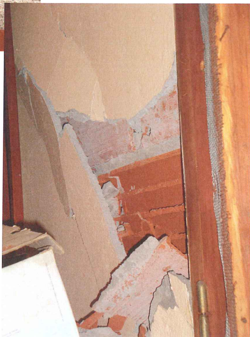
Fissure à l'extérieur et à l'intérieur d'un même panneau de façade.
