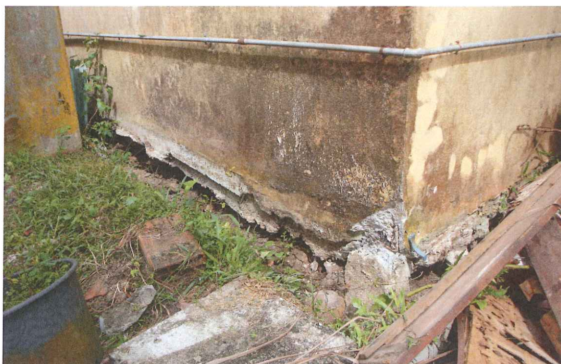
Détail en pied de l'angle de la maison montrant la précarité de la fondation. A noter la dégradation de la tête du poteau de la fondation et le vide sous les longrines des façades. Une rupture complète du poteau serait très préjudiciable pour la stabilité de la maison.
