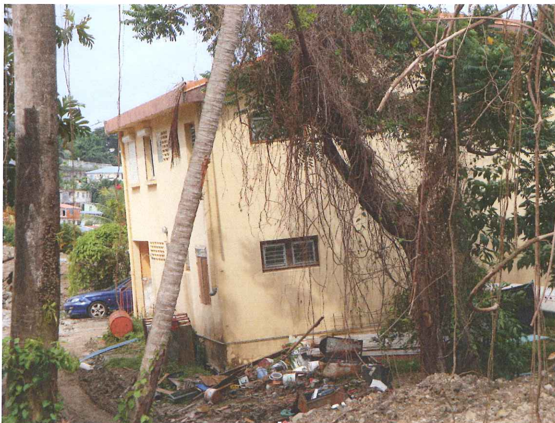
Vue d'un pignon de la maison mettant en évidence le basculement vers l'arrière (côté route de Moutte)
