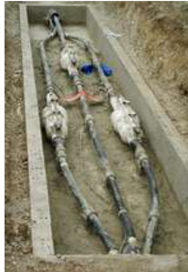
Exemple d'une chambre de jonction en milieu agricole
