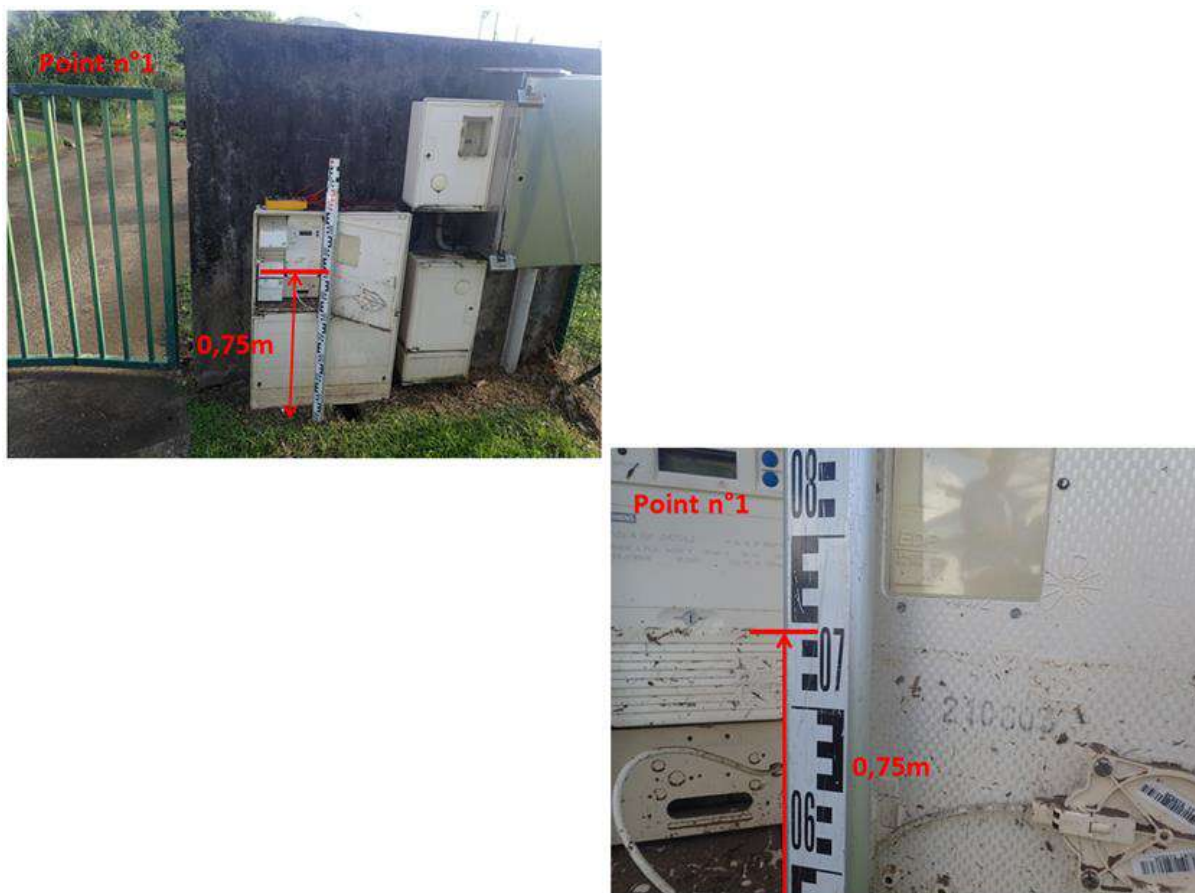
Figure 11 : Exemple de trace visible de ma montée des eaux (GRP4)
