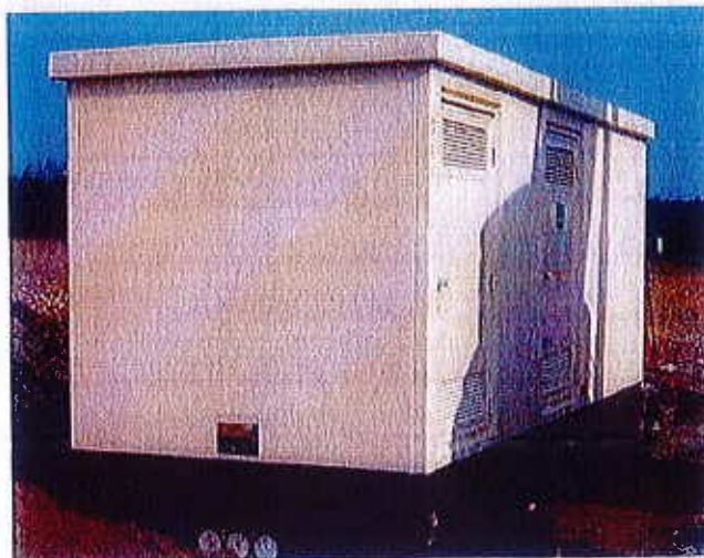
Figure 7 : Photo d'un poste de livraison (source : SUNPOWER)
