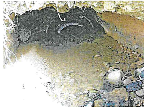
Photo 14 : Sortie de la buse après passage sous le stade et avant carrefour D24bis et N1: très mauvais état et nombreux effondrements (écoulements principaux)
