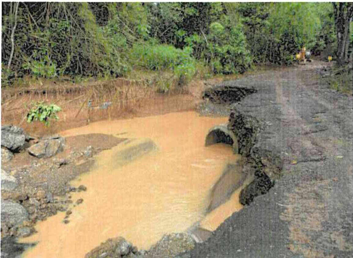
Figure 6. Photo représentant l'état de la piste en 2009 (sortie de l'ouvrage 3) avant travaux engagés par Gravillonord.
