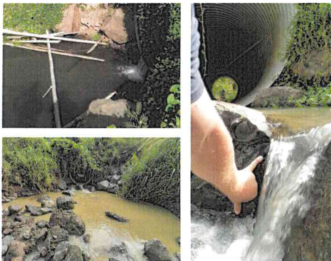
Figure 51. Schéma et photos du seuil en sortie de l'ouvrage n°4. Avril 2017, Août 2018, et Novembre 2020 avant travaux.
