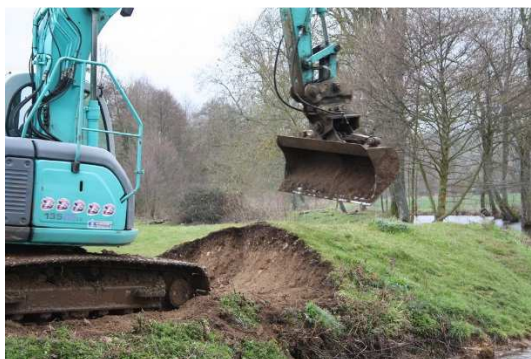
Figure 23 : Exemple de merlon de curage en cours d'arasement en bordure de rivière (Saviton)
