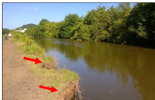
Figure 13 : Erosion en rive gauche sur le Canal du François (Safege - 22/08/16)
