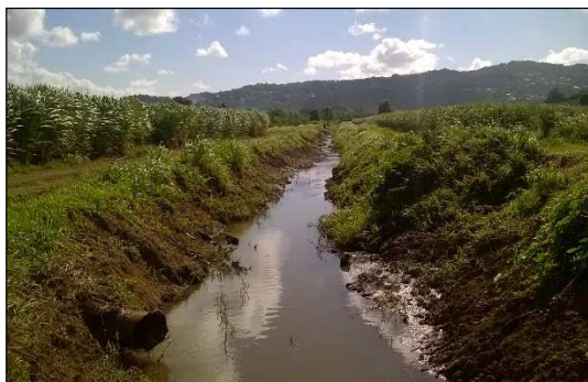
Figure 4 : Nouveau lit de la rivière Desroses, rectiligne et sans ripisylve (Safege - 22/08/16)
