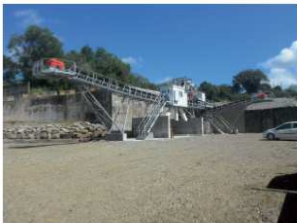
1/ Vue sur la nouvelle unité de tri
