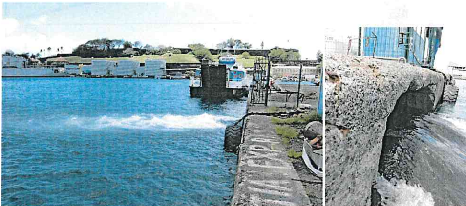
Figure 17 : Point de rejet en mer existant des eaux de vidange du bassin (Source : Suez Consulting, 2020)
