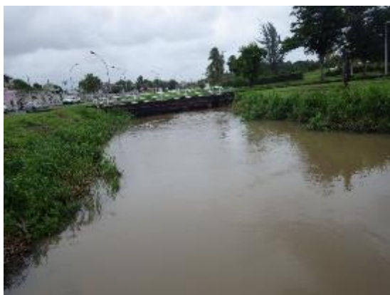
29/09/16 10h43 : le tablier du pont de l'Avenue Georges Gratiant à quelques cm des eaux du Canal Mamin (DEAL)
